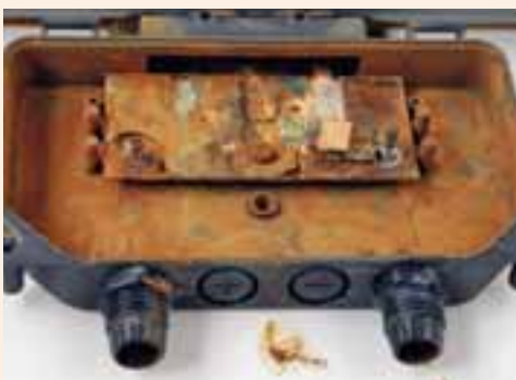
Wenn Feuchtigkeit eindringt ist das Solarmodul irreparabel ...
